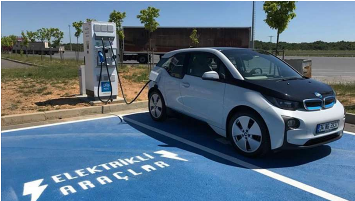
Şekil 17: Örnek Elektrikli Araç Şarj İstasyonu
